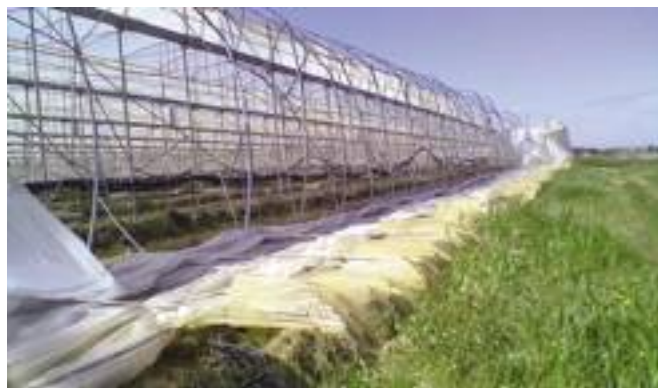
Serra con struttura metallica gravemente danneggiata da vento ciclonico.
